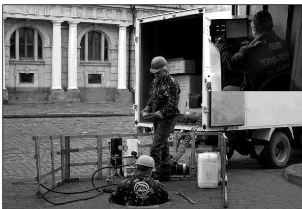
Рис. 3. Працівники пересувного діагностично-відновлювального комплексу під час проведення відновлювальних робіт на каналізаційному колекторі на проспекті Свободи біля Львівського Оперного театру
