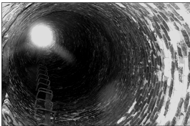
Рис. 4. Пошкоджена корозійно-механічними процесами димова труба котельні КП «Житомиртеплокомуенерго» перед ремонтом
