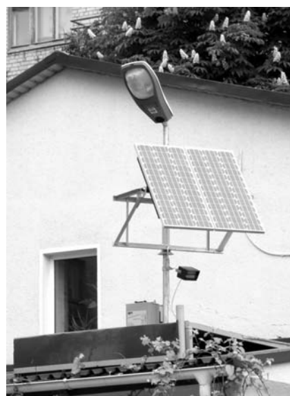
Рис. 2. Солнечная энергоустановка для электропитания уличных фонарей
