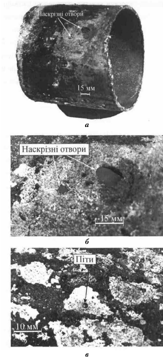
Рис. 1. Зруйнована частина підземного газопроводу: загальний вигляд (а), конфігурація наскрізних пошкоджень (б), розташування пітів вздовж зварного шва (в)
